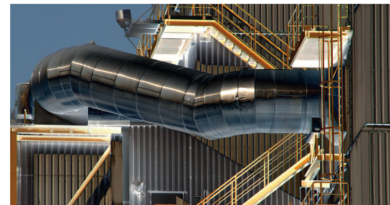
Täglich werden etwa 700 Tonnen Siedlungsabfälle in den drei Müllkesseln zu umweltfreundlichem Dampf umgewandelt und von TWL weiterverwertet.
